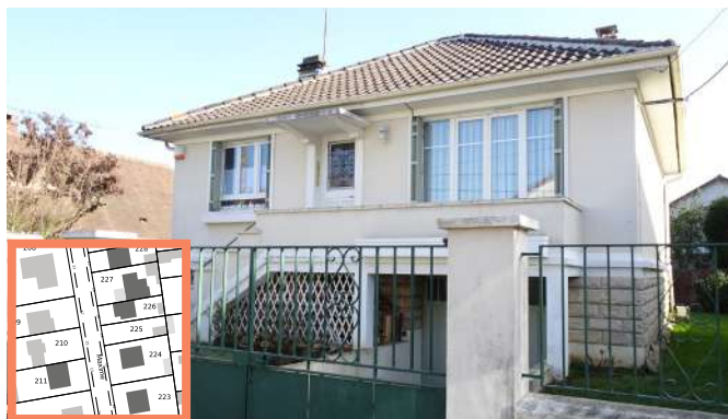
Maison des années 1950 en retrait de la rue avec toiture en avancée et sous-face en bois. L'auvent au-dessus de la porte est en béton.
