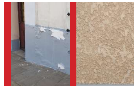
Enduits plastiques à proscrire : ils ne permettent pas les échanges thermiques, sont très uniformes, possèdent une finition inadaptée et le plus souvent masquent les anciens décors.
