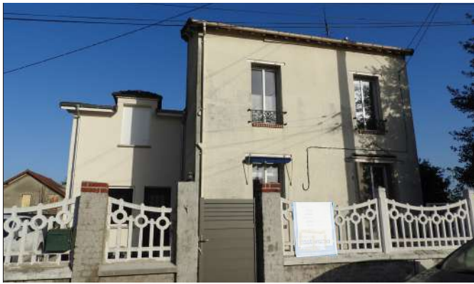
Les proportions de l'extension de gauche s'accorde plutôt bien avec le bâti existant bien que celui-ci ait subi lui aussi quelques modifications tendant à le banaliser.
