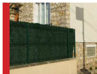
Haie artificielle à éviter
