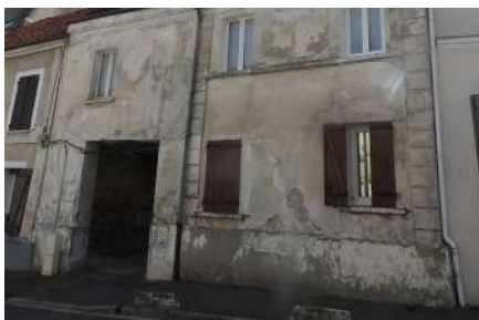
Enduit ancien au plâtre et corniche en plâtre qu'il serait souhaitable de restaurer.
