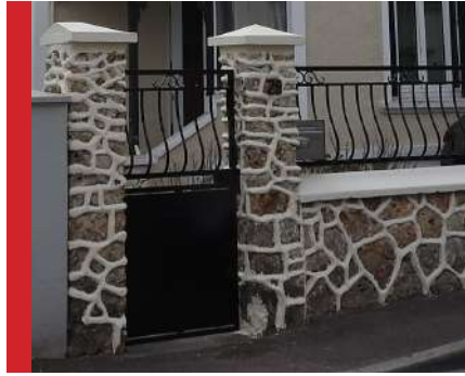
Mise en œuvre de joints trop larges et trop en relief à éviter.
