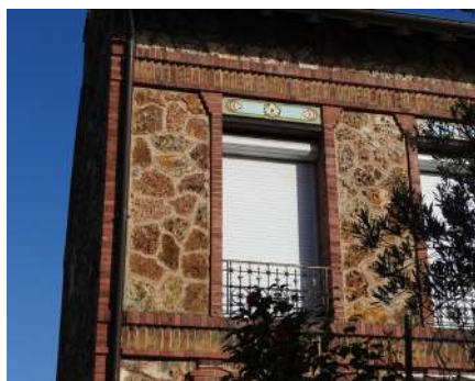
Exemple de joint de couleur rosé. Décors en briques et céramiques.
